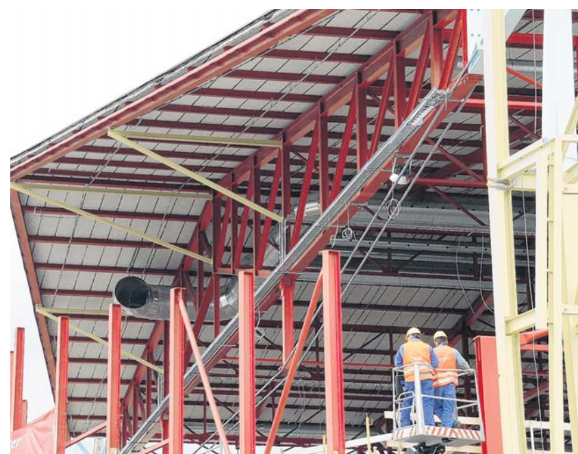
Eindrucklich: Das 420 Tonnen schwere Lido-Dach, angehoben in fünf Meter Höhe und mit den neuen Diners Club Arena-Stützen verschraubt.
